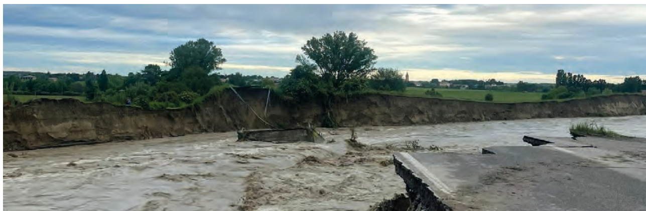
Il Ponte della Motta (BO) crollato dopo l'alluvione di maggio 2023 – Fonte Wikipedia
